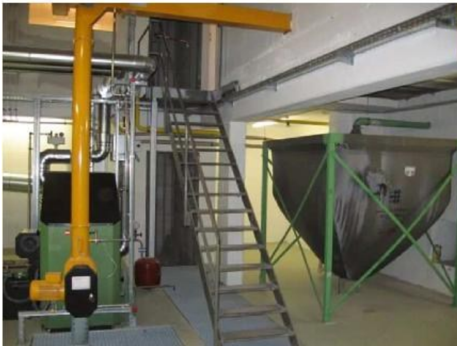
Stadt Freiburg: Pelletheizung
