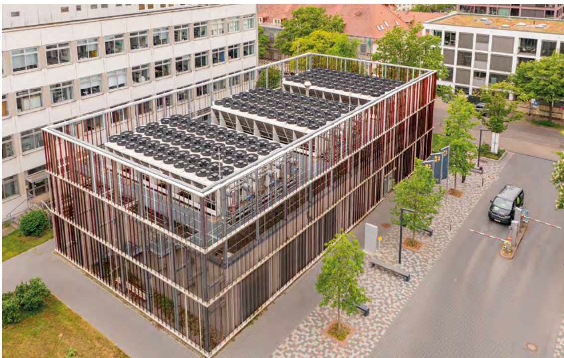
Die Kälteanlage versorgt u.a. die raumlufttechnischen Anlagen für den OP-Bereich, die Intensivstationen oder auch technische Bereiche. (© Städtisches Klinikum Karlsruhe, Markus Kümmerle)
