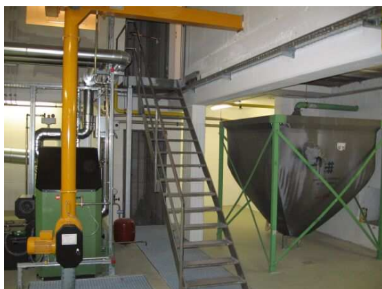
Abb. 11: Stadt Freiburg: Pelletsheizung
