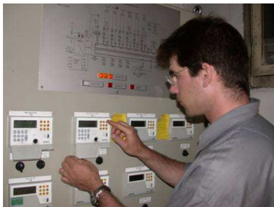
Abb. 8: Stadt Stuttgart: Überprüfung und Einstellung der Regelungsparameter einer Lüftungsanlage
